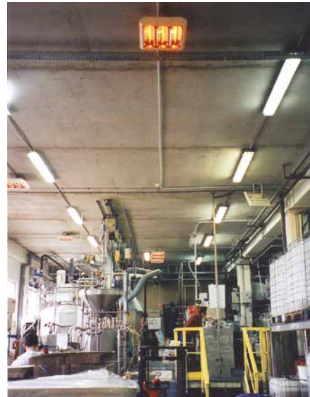
IRCF kan monteras på vägg eller i tak, och är lämplig i byggnader som inte används regelbundet, t.ex startzonen på den här gocart-banan.
