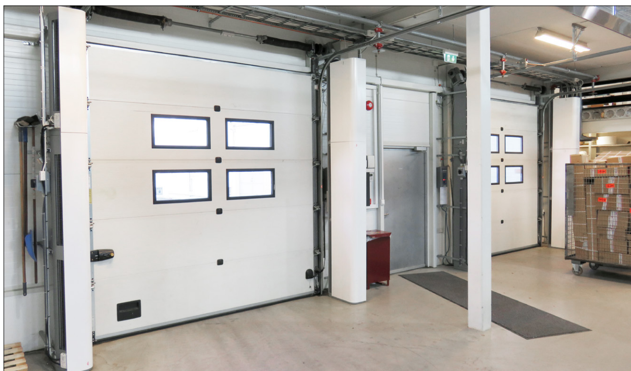
Vertikalt montert Pamir 5000 med en vertikalpakke som tillater at to aggregater installeres oppå hverandre.
