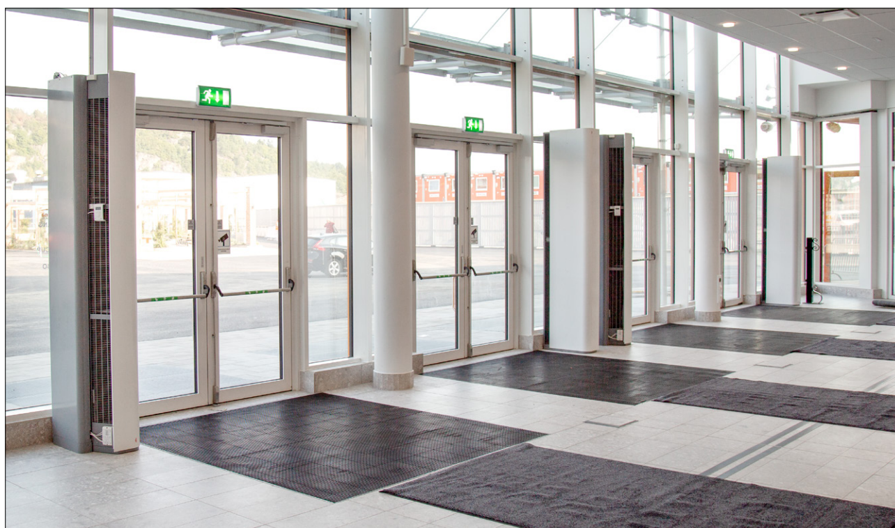
Zamontowane pionowo urządzenia Pamir 3500 z zestawem maskownic do ukrycia rur i przewodów.
