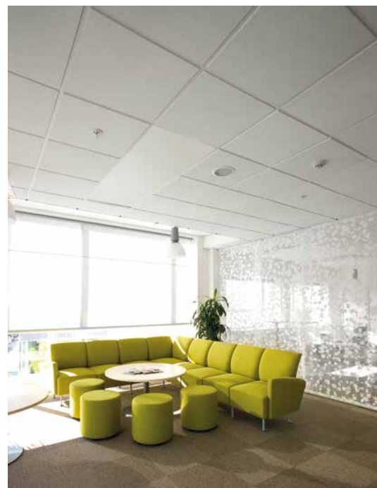
Med värmestrålare värms luften indirekt, vilket ger ett behagligt och dragfritt inneklimat med en jämn temperatur.
